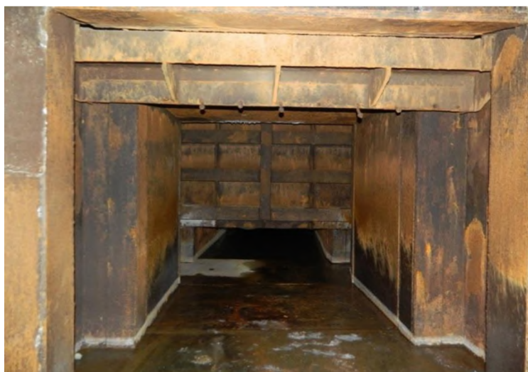
Рис. 5 - Эксплуатационный и ремонтный затвор Ыссык-Атинского БДР
