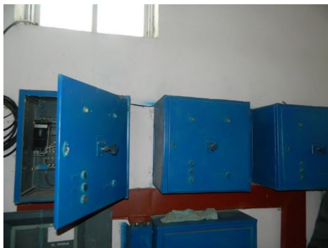
Рис. 7 – Электрический щит -подъёмник Ыссык-Атинского БДР
