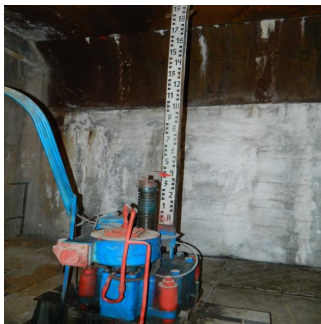
Рис. 6 - Гидравлический подъёмник Ыссык-Атинского БДР
