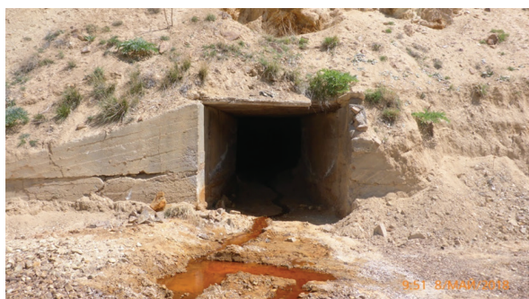
Рисунок 2 – Выход шахтных вод из одной из штолен Канчоча
