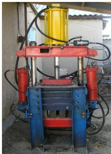
Рис. 8. Общий вид и подключение преобразователя скорости перемещения штока прессующего гидроцилиндра на прессовое оборудование для производства крупноформатных строительных изделий
