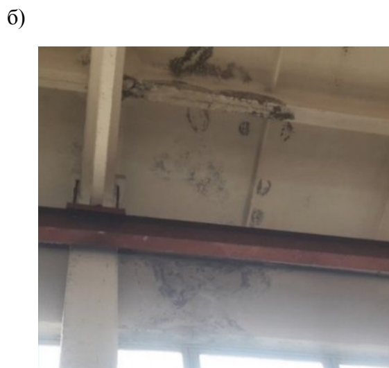
Рис.1. Протечки с крыши: а)коррозийное разрушение, пятна ржавчины, шелушение и выпадение шпаклевочного слоя; б) разрушена отделка в плитах покрытий, трещина, следы промерзаний и коррозионное разрушение в на стенах в местах опирания
