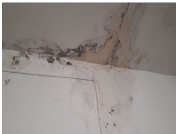
Рис. 2. Вздутие и отпадение местами отделочного слоя и шелушение поверхности штукатурного слоя
