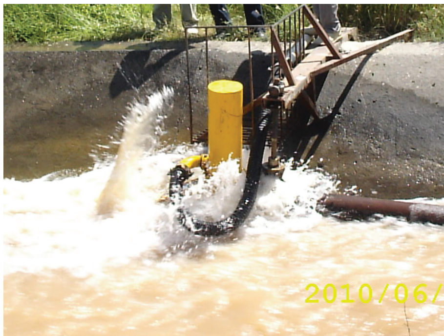
Рисунок 1 – Модернизированная насосная установка “Гидротаран” на канале-быстротоке
