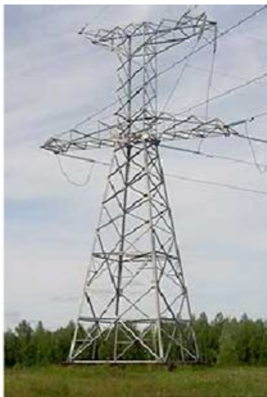
Рис. 31. Внешний вид опоры воздушной линии
