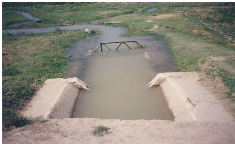
Рис. 3.5. Гидропост на Р-15 затоплен водой, скорость течения воды не превышает 0,05...0,10 м/с.
