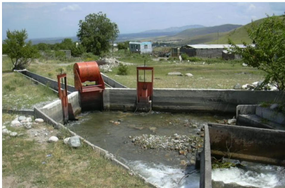
Рис. 1.22. Автоматизированный водораспределительный узел (АВУ) на канале Жаламыш Сукулукского района.
