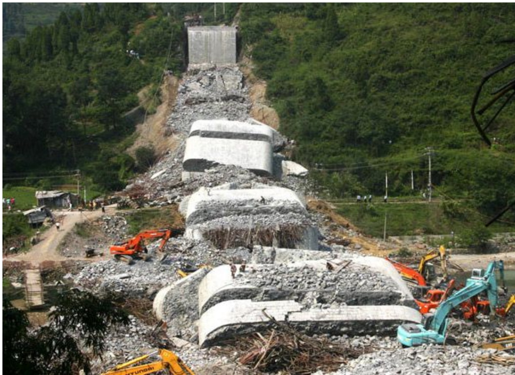
Рис. 1.16. Обрушение железобетонного моста в Китае
