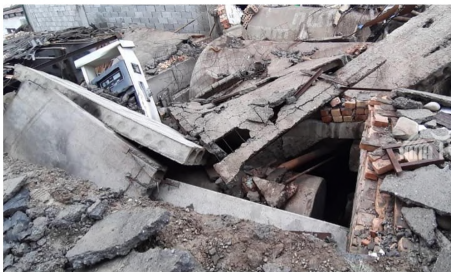
Рис.3. Состояние резервуара АЗС «Октан Сервис» после взрыва
