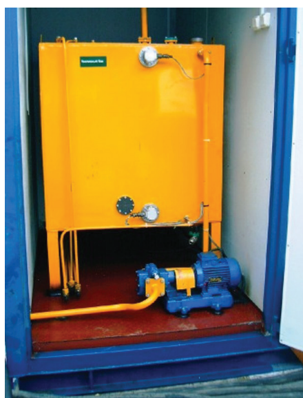
Рисунок 3 – Резервный топливный бак с топливоподкачным насосом, установленным в блок-контейнере
