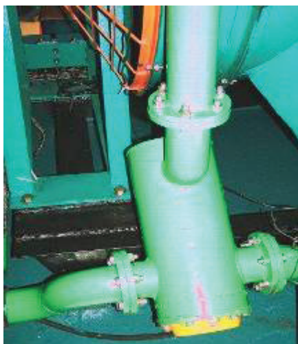
Рисунок 7 – Общий вид цилиндра с ТЭНами системы горячего резерва
