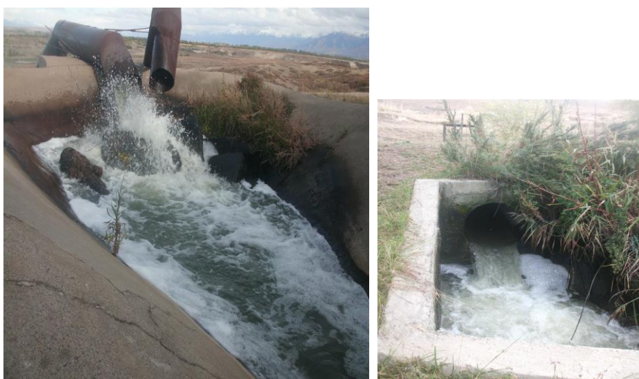
Рис. 3.24. Сточная вода на выходе насосной станции
