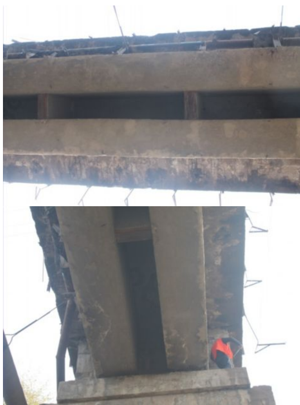
Рис. 3. Коррозия бетона железобетонных балок и оголение арматур в плитах балок
