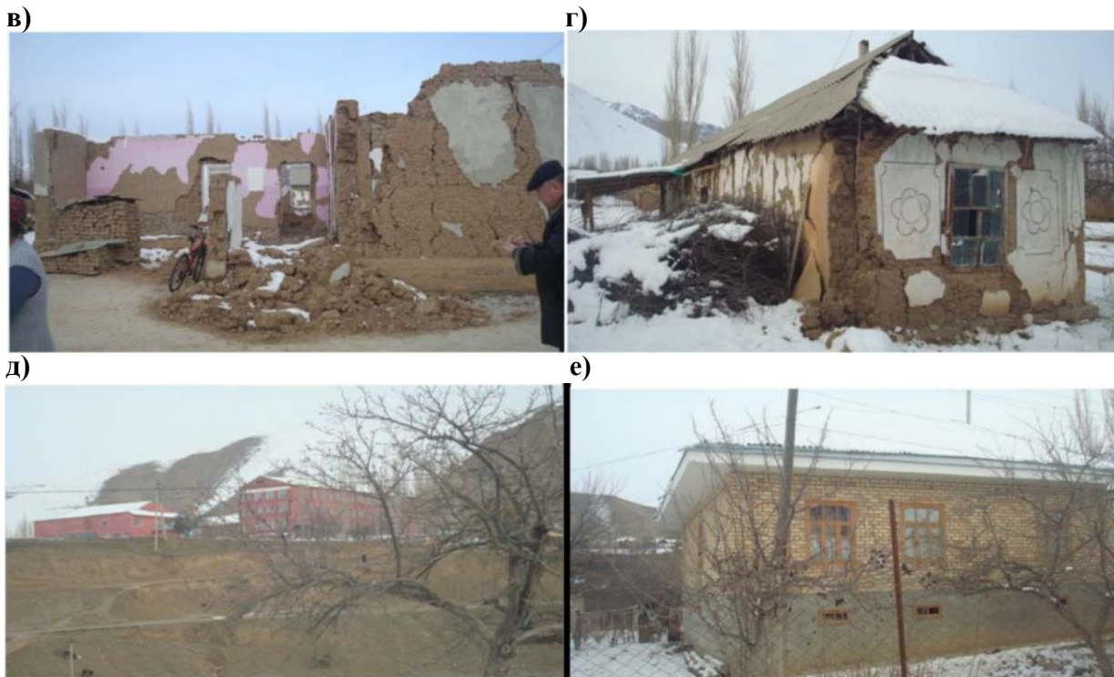
Рис.1. Поврежденные и неповрежденные здания в селе Чайчы: а - общий вид села Чайчы; б - повреждение дома из саманного кирпича; в - разрушение дома со стенами из кирпича сырца; г - повреждения дома без фундамента; д, е - не поврежденные здания.
