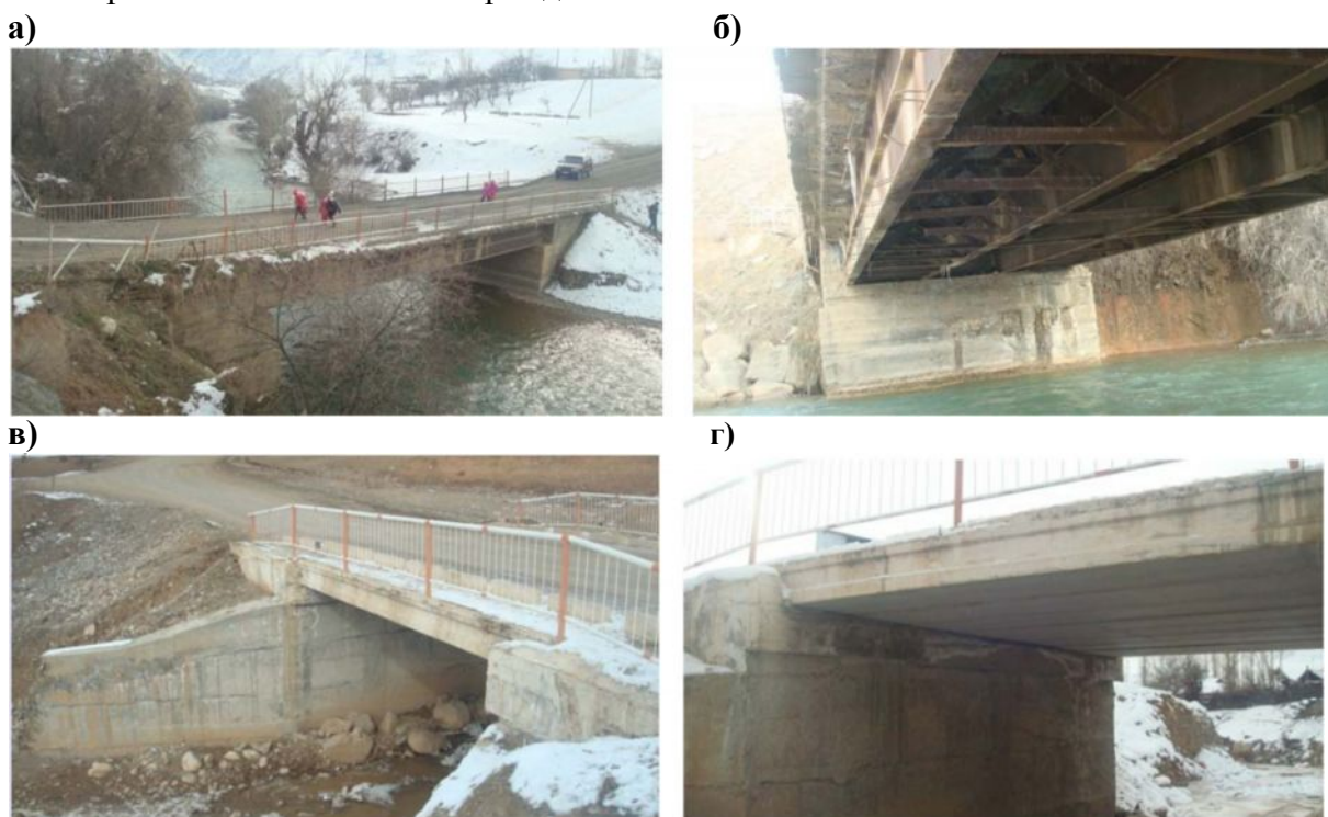
Рис. 2. Балочные мосты после 7 балльного землетрясения в селе Чайчы: а - балочный мост с металлическими пролетными строениями; б - пролетные строения моста; в - ж/б плитный мост; г - опоры и плиты пролетного строения ж/б моста.
