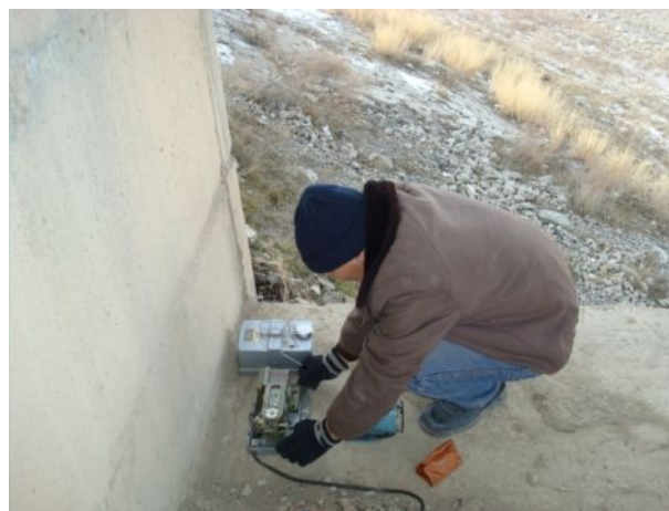
Рис.П.6.1.2. Установка сейсмоприемника СМ-3 , ОСПГ на фундаменте (точка наблюдения \Delta_3 , \Delta_6 )
