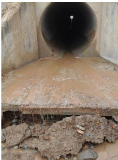
Рис. 4. Размыв выходного укрепления трубы
