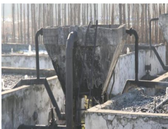
Рис.4. Распределительная чаша очистного сооружения города Джалал-Абад
