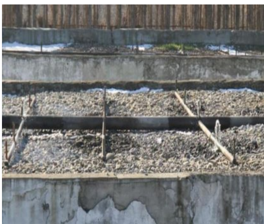
Рис.3. Биофильтры очистного сооружения города Джалал-Абад
