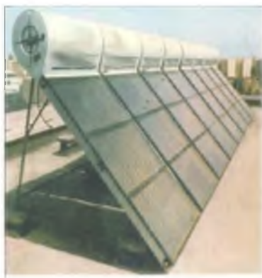
Рис. 4. Система солнечных установок на крыше жилого дома в г.Бишкек
