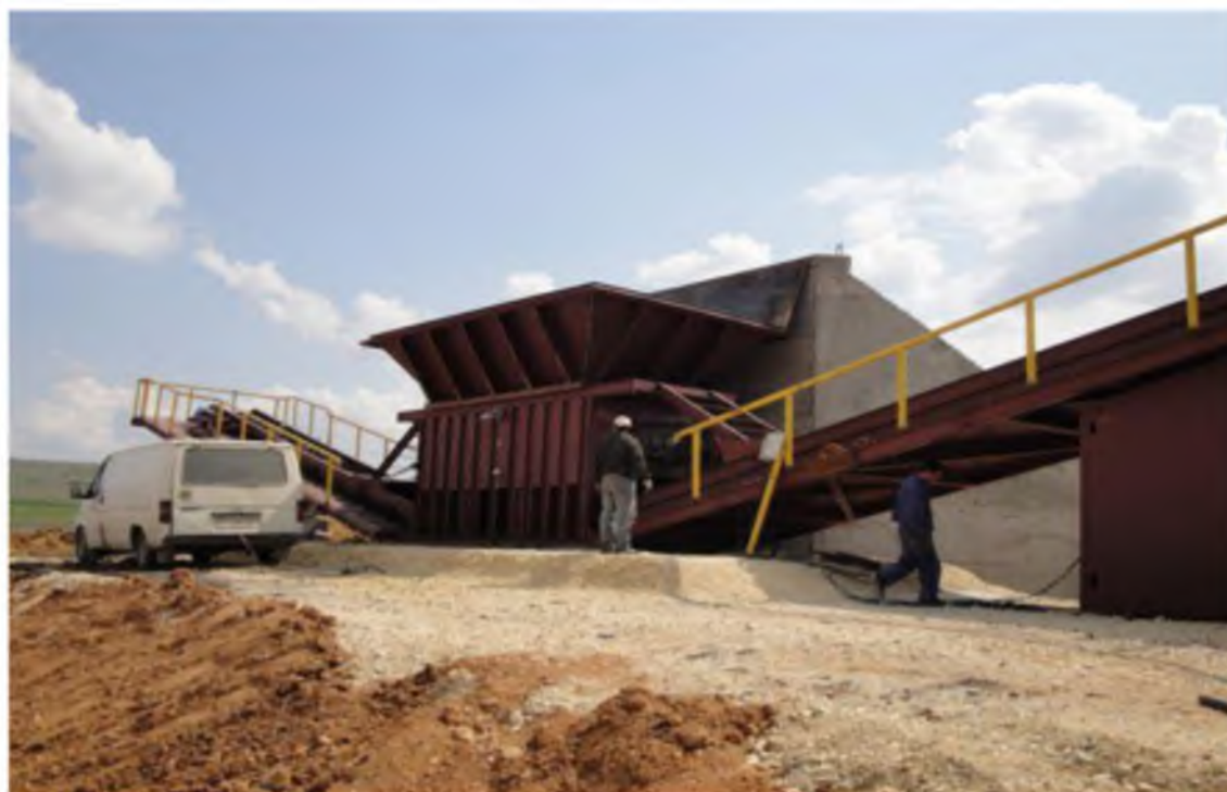
Рис. 4. Конструкция комплекса ДСКА производительностью 600 т/час для одностадийного дробления (до фракции 0-25 мм) и сортировки лигнита в варианте поставки компании “Bitola” (Республика Македония)
