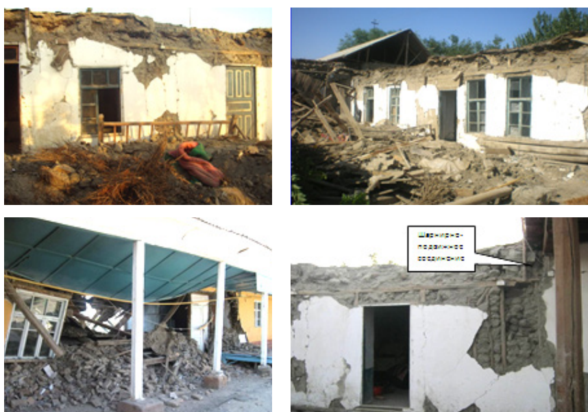
Рисунок 1 – Состояние домов после землетрясения в Ферганской области, Узбекистан, 2011.
