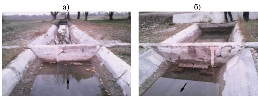
Рис.6. Водомерное сооружение типа «Прямоугольный насадок» на распределителе Р-2-6 системы ЗБЧК. а – вид с верхнего бьефа; б – вид с нижнего бьефа. 1 – диафрагма; 2 – рейка; 3 – верх (плита) насадка.
