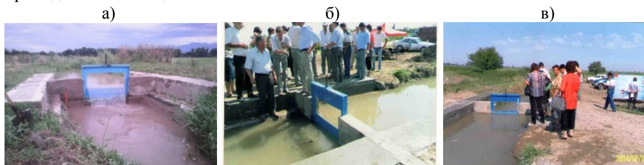
Рис.8 Водомер типа «Водослив-насадок» на Р-8 системы ЗБЧК. а – вид с нижнего бьефа (замер воды осуществляется водосливом); б, в – участники выездного семинара на сооружении Р-8 системы ЗБЧК (вид с верхнего бьефа) - обсуждается увиденное (замер воды осуществляется водомером типа «Прямоугольный насадок»).
