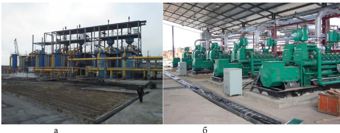
Рис. 1. Общий вид газогенераторной (а) комплекса и электростанции (б) на базе газопоршневых установок
