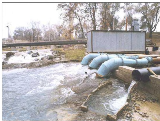
Рис. 10 Действующая микроГЭС в пригороде г.Бишкек, мощность 66 кВт
