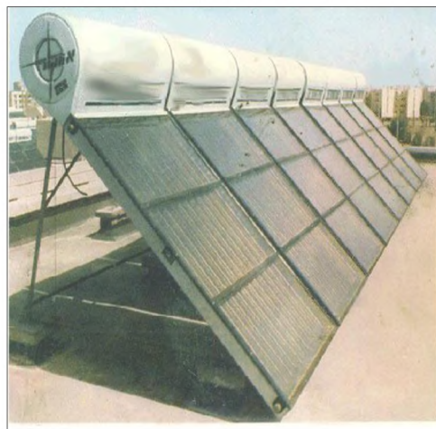
Рис. 9 Система солнечных установок на крыше жилого дома в г.Бишкек
