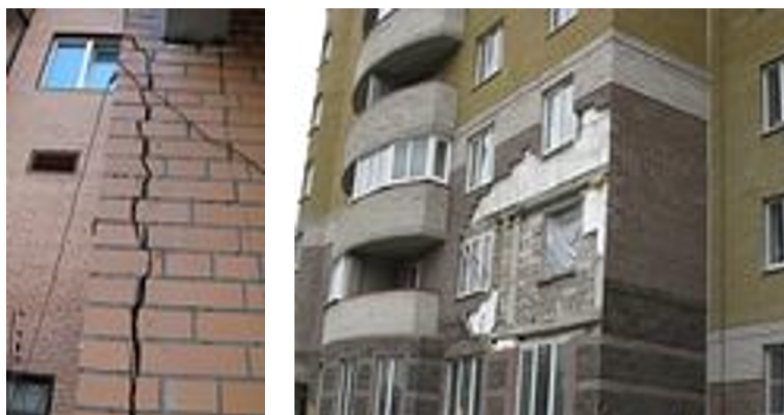
Фото 1 – Дефекты трехслойных стен с фасадной облицовкой из кирпича
