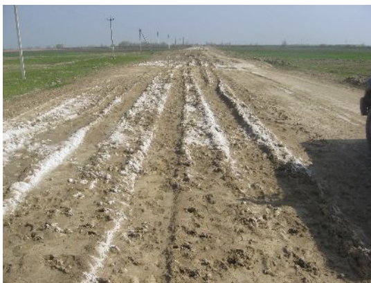
Рис. 1. Земляное полотно из засоленного грунта
