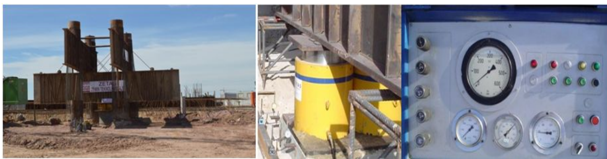
Рис. 2. Вертикальные статические испытания свай методом SCQLT а) опытная свая и реперная система; б) датчики перемещения и домкраты; в) гидравлическая система.
