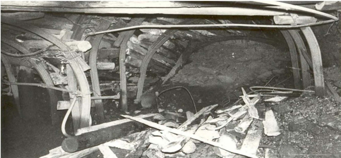
Рис. 2. Разрушение подготовительной выработки на глубине 350 м. Факторов (Кадамжай)
