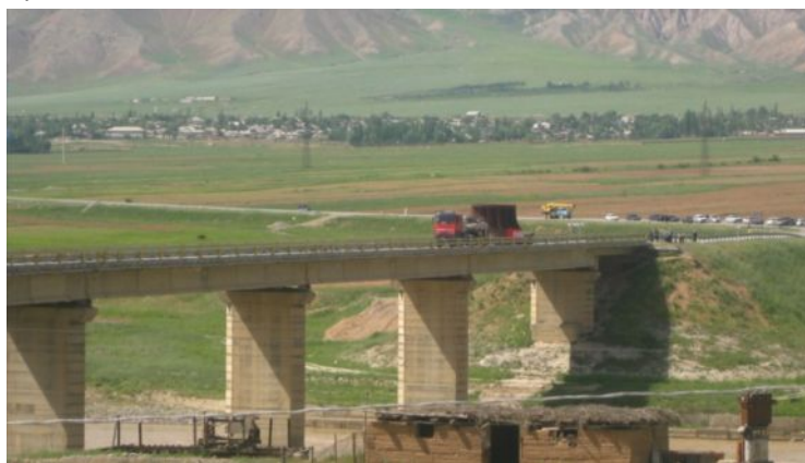
Рис. 4. Проезд сверхнормативного груза общим весом 129 т через р. Нарын на 318 км автомобильной дороги Бишкек – Ош.
