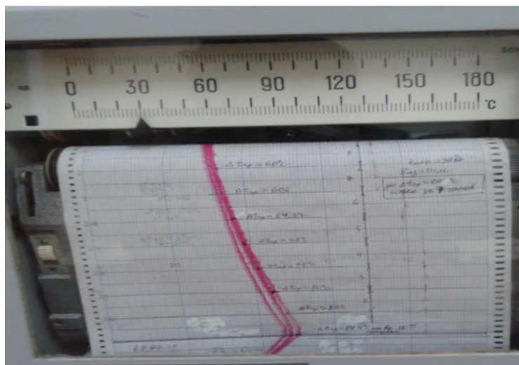
Рис.4. Фрагмент записи ленты с температурой воды в баке-аккумуляторе.
