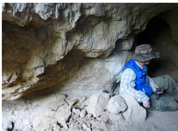
Рисунок 6 – Обрушения стен в северной части монастыря. В коридор проникает свет из образовавшегося сквозного отверстия
