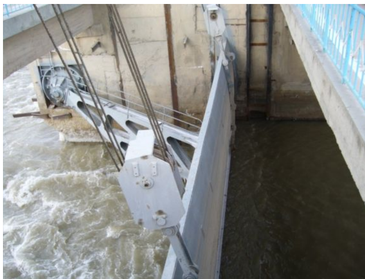
Рис. 4.11. Сегментный затвор Кызылординского гидроузла
