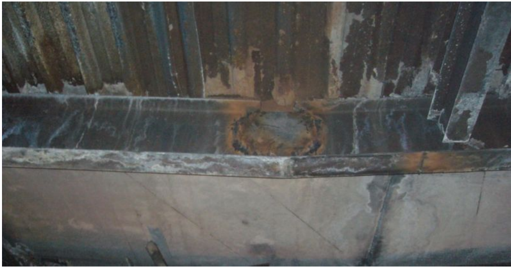
Рис. 3.15. Коррозия балки производственного объекта химического предприятия
