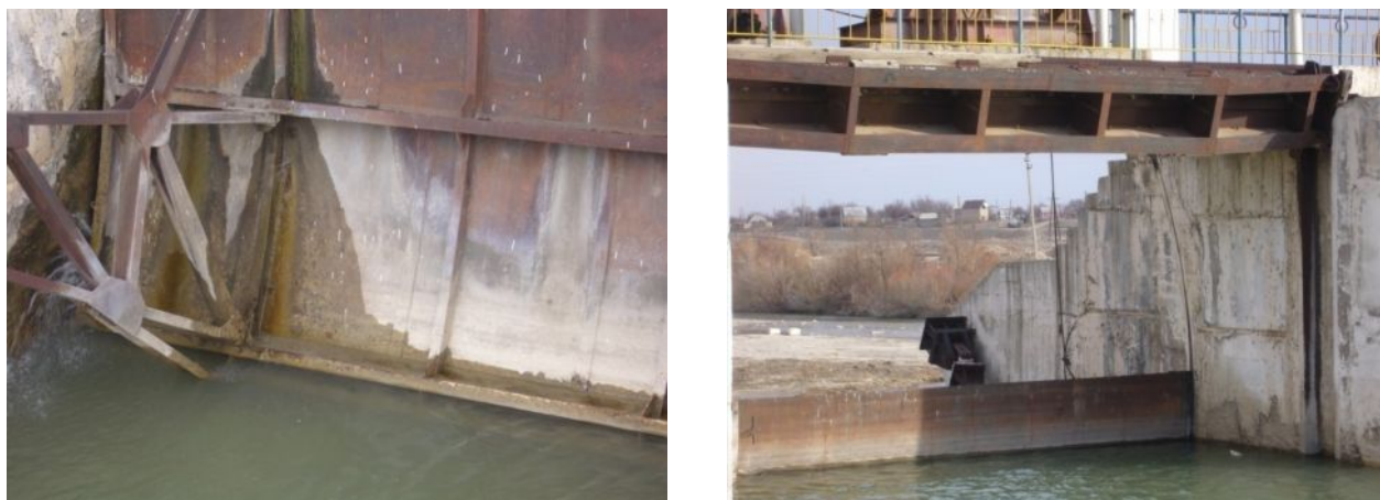
Рис. 4.1. Коррозионные повреждения сегментного затвора и ремонтных шандоров
