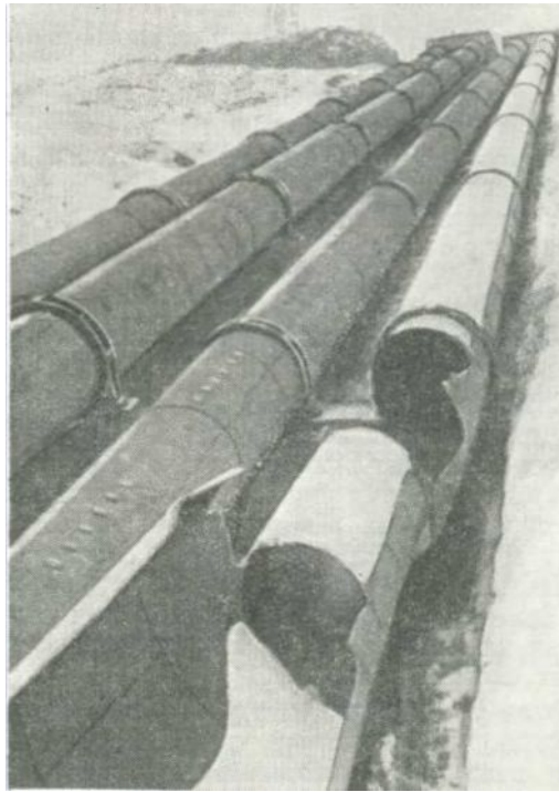
Рис. 1.1. Вид разорванного трубопровода
