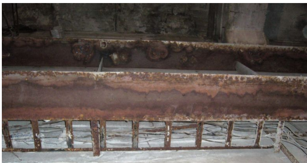
Рис. 3.18. Коррозия подкрановой балки производственного объекта химического предприятия
