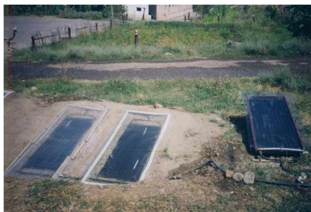
Рис. 2. Общий вид грунтового солнечного водонагревательного коллектора.
