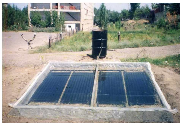
Рис. 3. Общий вид солнечной водонагревательной установки.
