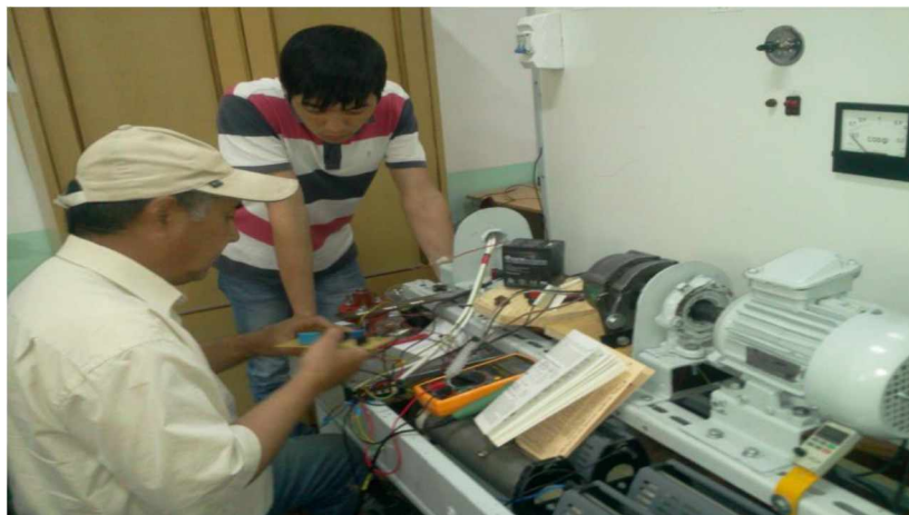
Рис. 5. Испытательный стенд для предварительного определения нужной мощности и частоты вращения на валу асинхронного двигателя, используемый в качестве генератора для работы МикроГЭС
