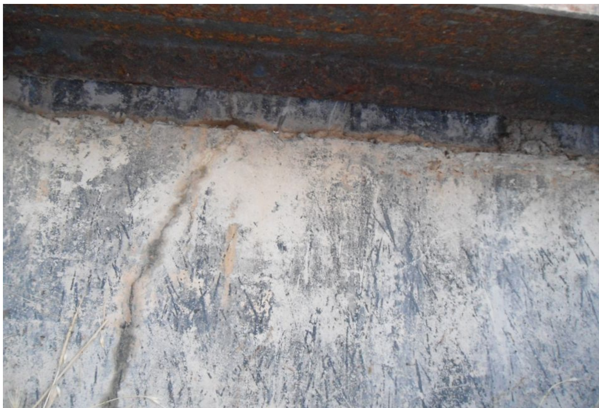
Фото 13 Вид снаружи вертикальной трещины на стенке резервуара чистой воды
