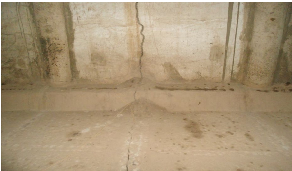
Фото 5 Трещина в стене, переходящая на днище резервуара чистой воды
