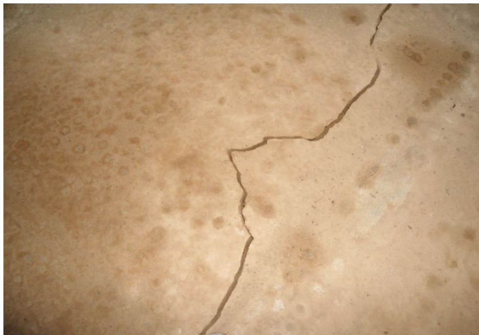
Фото 3 Трещина на днище резервуара чистой воды (ширина трещины около 35мм, длина более 18 м)
