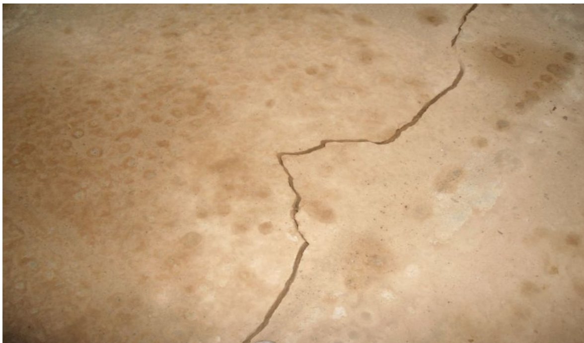
Рис. 2.3. Вид трещины на днище РЧВ
