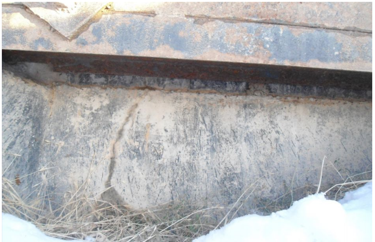
Фото 12 Вид снаружи вертикальной трещины на стенке резервуара чистой воды
