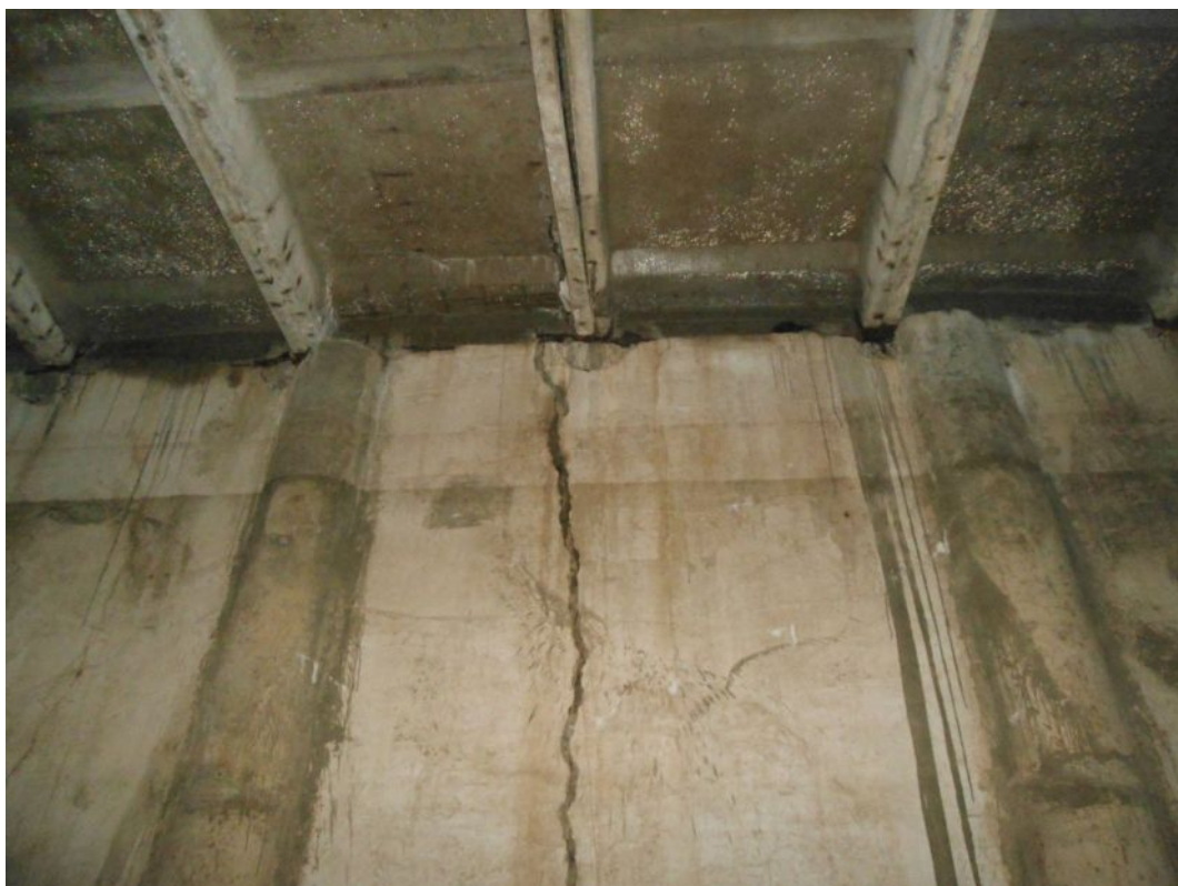
Фото 7 Вид трещины в стенке резервуара чистой воды (ширина до 50 мм, длина по всей высоте стенки 3,64 м)
