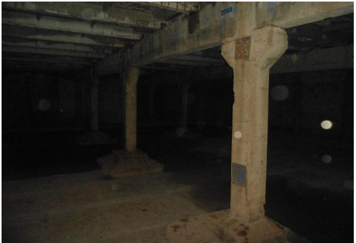
Фото 10 Вид резервуара чистой воды до осуществления восстановительных работ
