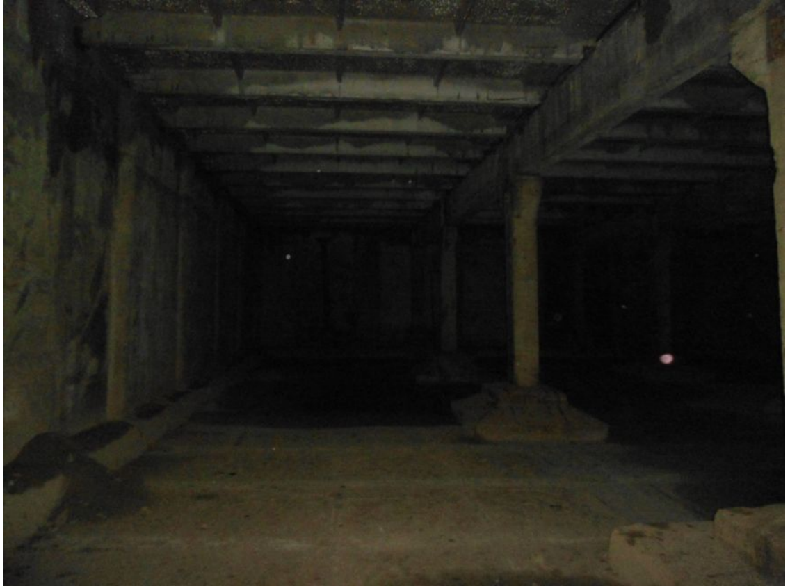
Фото 9 Вид резервуара чистой воды до осуществления восстановительных работ
