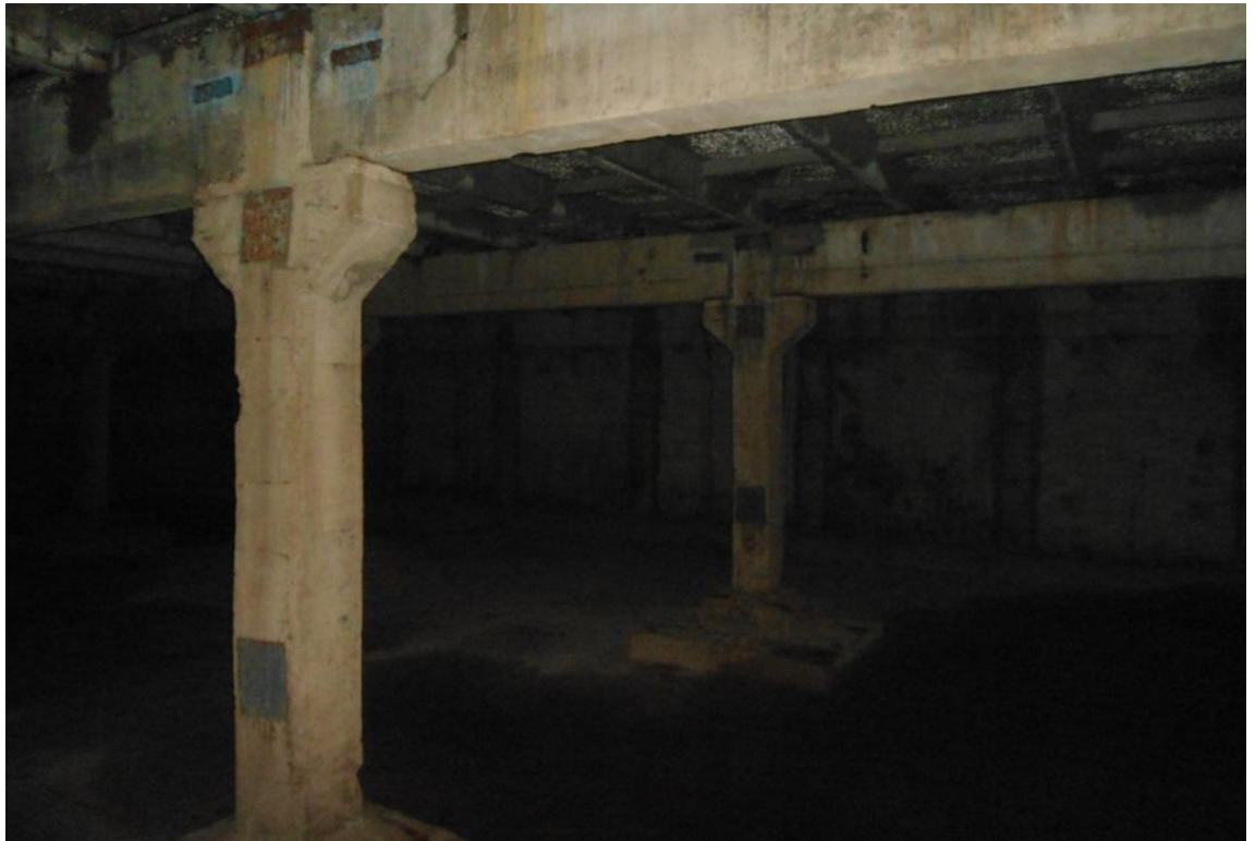
Фото 11 Вид резервуара чистой воды до осуществления восстановительных работ
