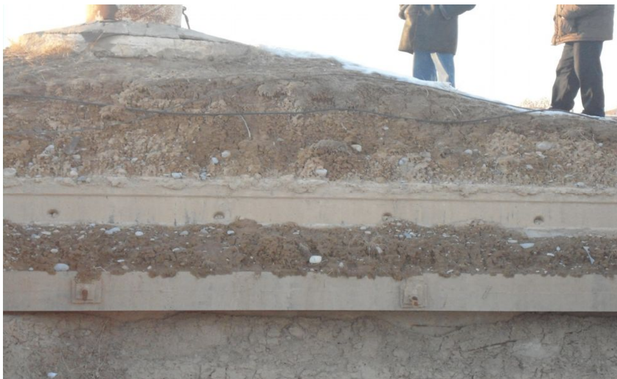
Фото 14 Вид обвала грунта обсыпки в районе образования трещины
