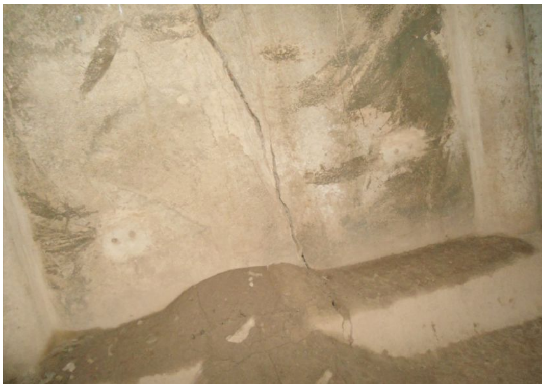
Фото 8 Вид трещины, переходящей от стенки резервуара на днище (угол стены и пола)
