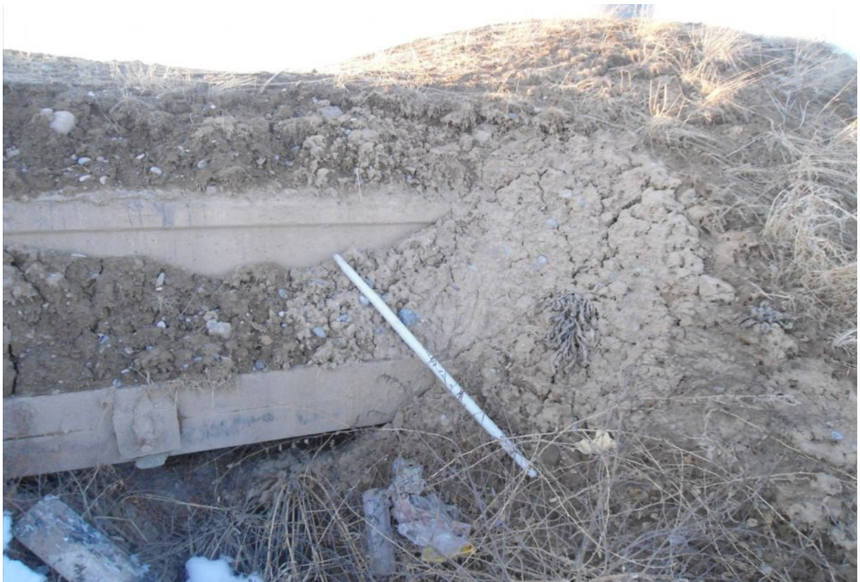
Фото 15 Вид обвала грунта обсыпки в районе трещины Фотографии резервуара чистой воды после реконструкции
