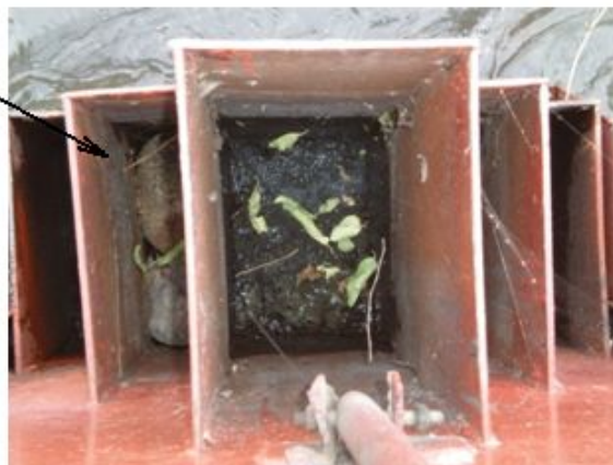
Рис.2.11. Секции стабилизатора расхода воды типа ССКЩ на канале «Джаламыш».
