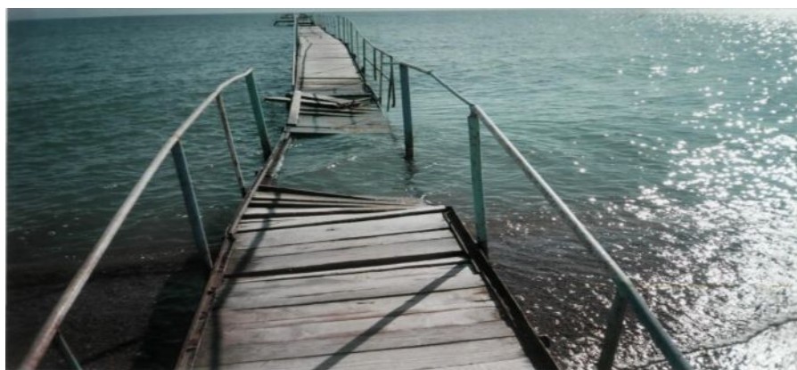
Рис. 2. Характер разрушения пирсов
