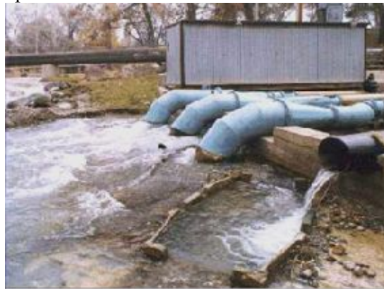
Рис. 11. Пример работы микро ГЭС в пригороде г. Бишкек.
