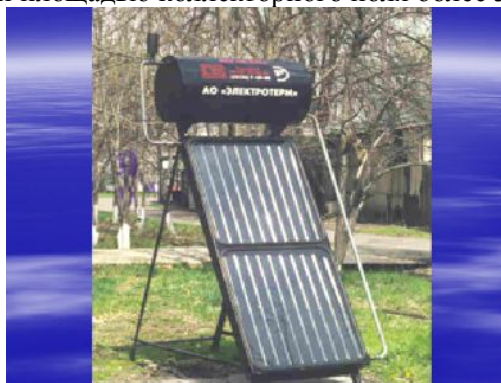
Рис.9. Солнечная водонагревательная установка.
