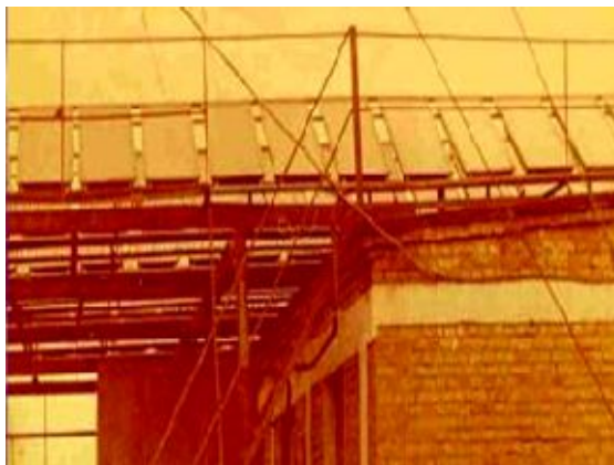
Рис.8. Комбинированная солнечная установка с котельной на МТФ.
