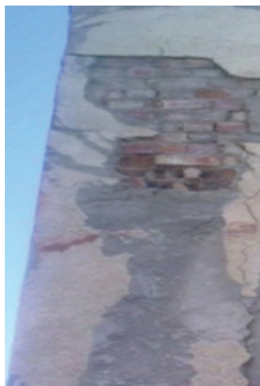
Рисунок 2 – Разрушения кирпичной кладки
