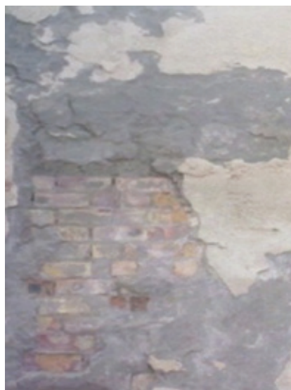
Рисунок 1 – Отслоение кусков штукатурки
